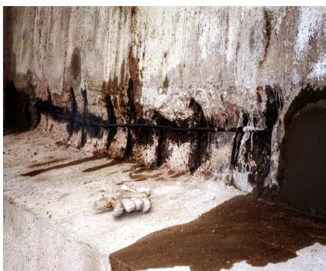
Rys. 5 Liniowy ubytek betonu przy dnie zbiornika o objętości około 20 dm 3 na 1 mb długości. Klasa ekspozycji XA2, 4,5> pH \leq 5,5. Naprawa konstrukcyjna
