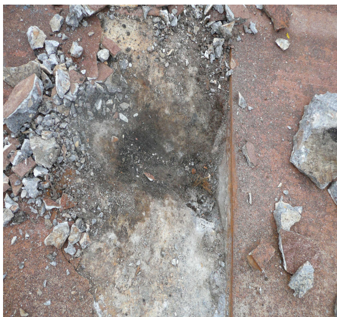
Rys. 4. Ubytki betonu o objętości około 3 dm 3 w dnie zbiornika na ścieki . Osadnik wstępny o klasie ekspozycji XA1 i pH \geq 6. Naprawa niekonstrukcyjna
